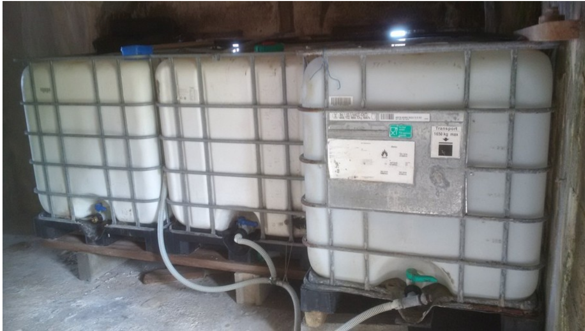
▲ Les cuves de stockage de l'eau dans le corps de garde
